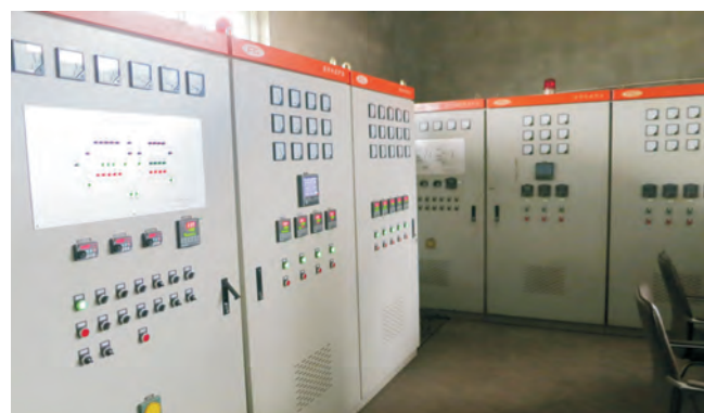
网带炉控制室 PLC Control Heat Treatment
